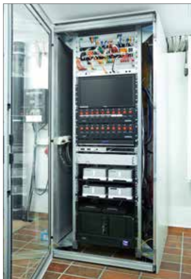
Alle zentralen Komponenten sind im Schaltschrank zu finden, Herz des KNX Systems ist der Gira FacilityServer im Zusammenspiel mit dem CEN.SYS Smarthome-Server.
