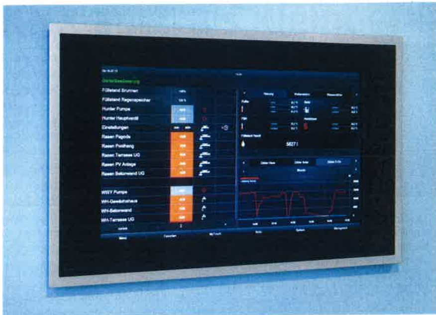
Bild 3: Die Inbetriebnahme eines Standard-KNX-Einfamilienhauses dauert üblicherweise nur einen Tag
