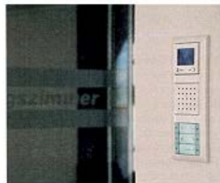
Wärmepumpen sowie die zentrale Lüftungsanlage werden über den Gira HomeServer mit-
